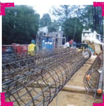
Cet imposant ferrailage sera mis en place avant le bétonnage du puits
